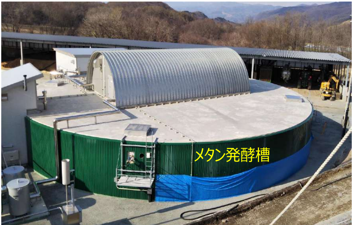
図 15 大屋原酪農協同組合 メタン発酵発電プラント(令和4年4月本稼働前)
